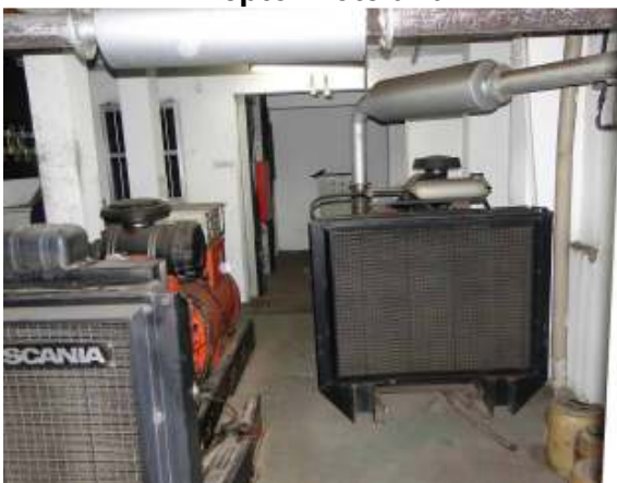
Central de Geradores
