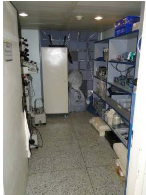
Sala de Equipamentos Centro Cirúrgico I
