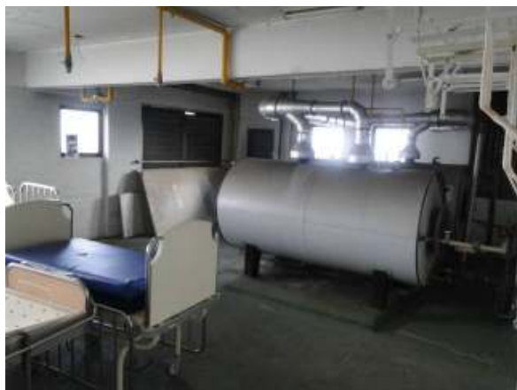
Central de Boilers 5º andar Bloco C
